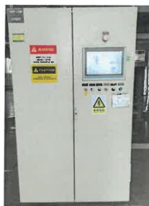
改造后锅炉控制柜样式
